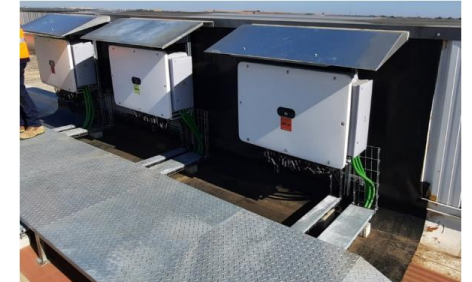
Manta ignífuga en inversores
